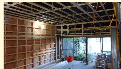
こちらレベルを確認しながら、壁と天井の下地を組んでいます。
