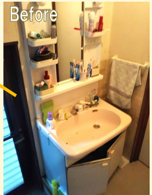
化粧台のボウルも劣化していました。
