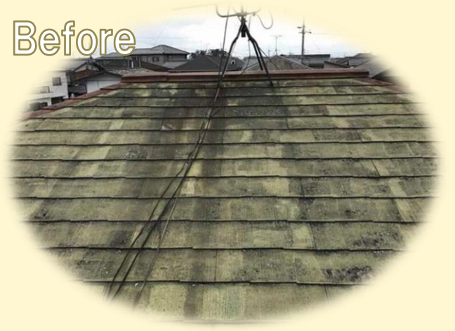
劣化が進行しておりました・・・
