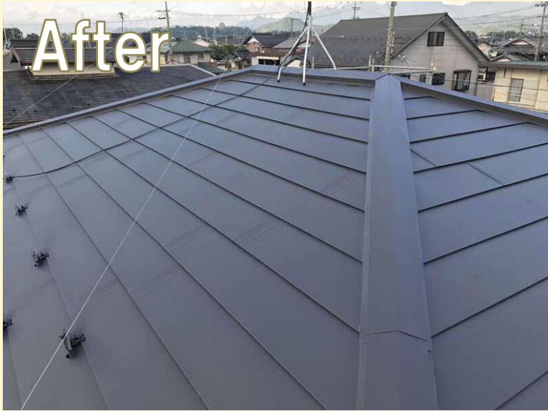
これでもう雨漏れの心配無し！
