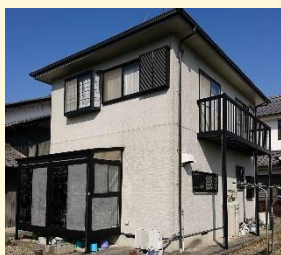
よく見ると白い外壁の所々に汚れが見受けられます。
