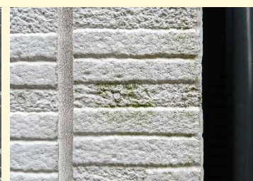
外壁目地のシーリング材の劣化と苔の発生があります。
