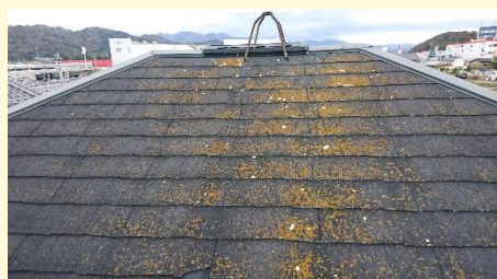
H様にご心配されていた屋根にはスレート屋根の劣化と苔の発生、鳥の糞汚れが目立ちます。
