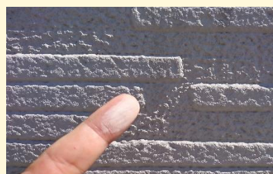
外壁のサイディング材にはチョーキング現象がみられます。
