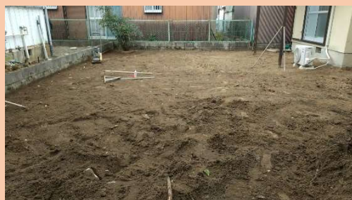
サンルーム設置場所と駐車スペースの整地をしています。
