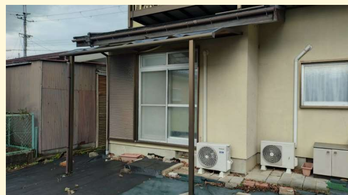
長年使ってこられたテラス屋根の劣化が進んできました。
