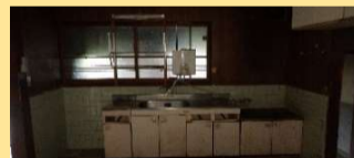
キッチンは床が劣化していて、少し暗い雰囲気でした。
