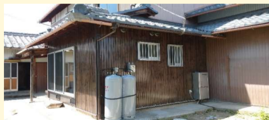
シルバーのサッシと新しい外壁でピカピカの外観になりました！
