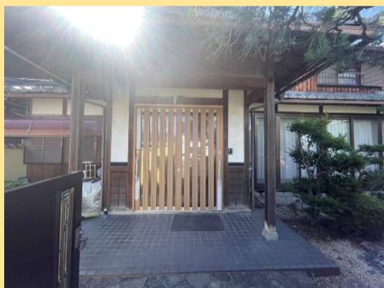
玄関の柱は紫外線による劣化現象により浸透した汚れが付着していました。
