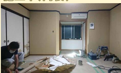
既存の内装とイメージが合う様に 選んだ内装材を丁寧に貼っています。
