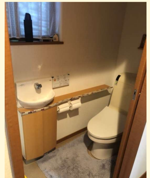
介助するには少し狭いトイレでした。
