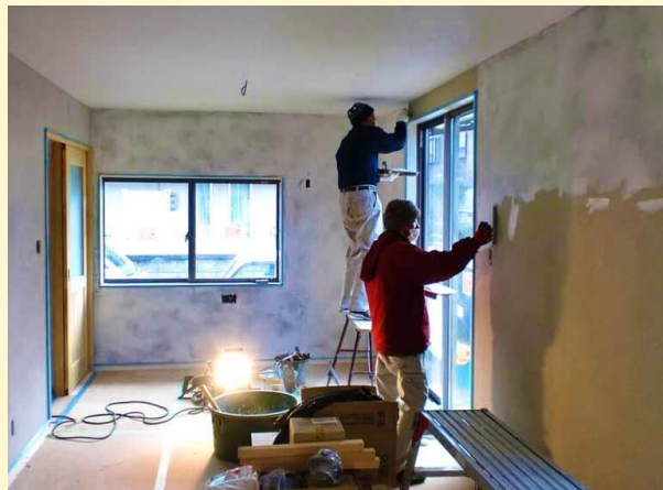
LDKの壁は調湿効果の高い珪藻土を塗っています。熟練された左官屋さんの技術が光ります。
