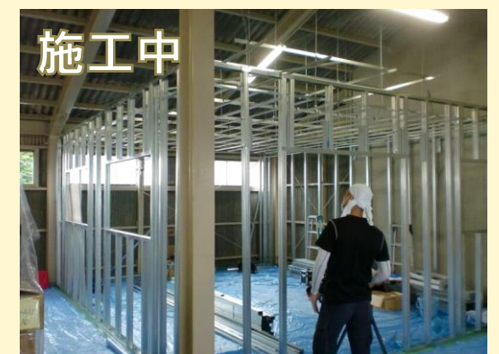
軽天で壁、天井の下地を組みます。開口寸法に気を付け、設計図通りに組み上げてもらいます。
