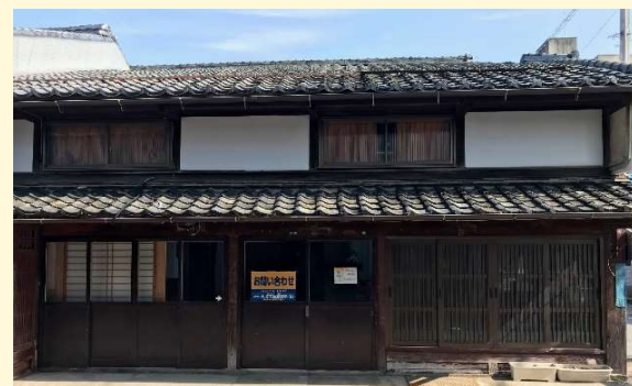
玄関と正面壁が経年劣化していました
