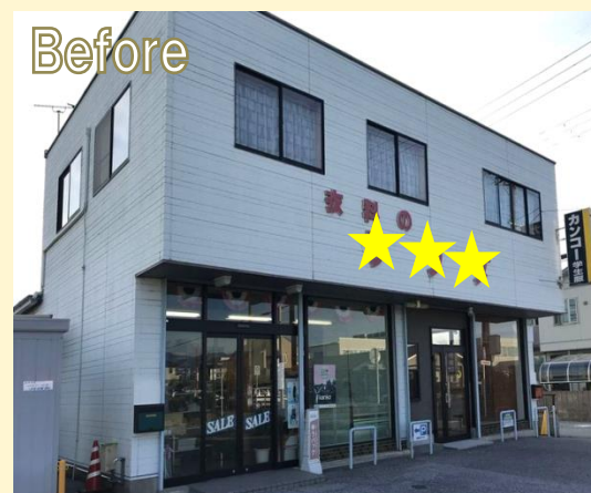
外壁の傷みも酷かった。
