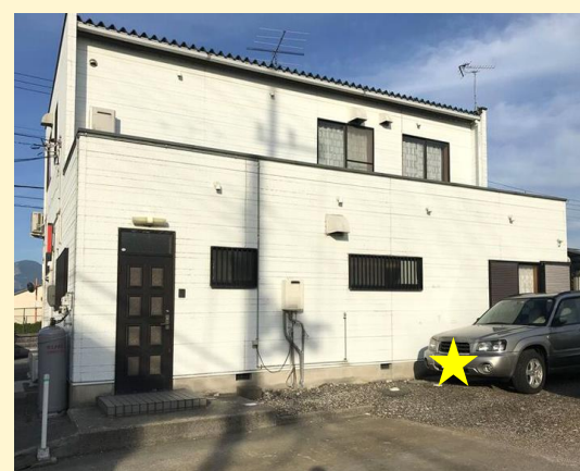
コーキングの割れも酷い。
