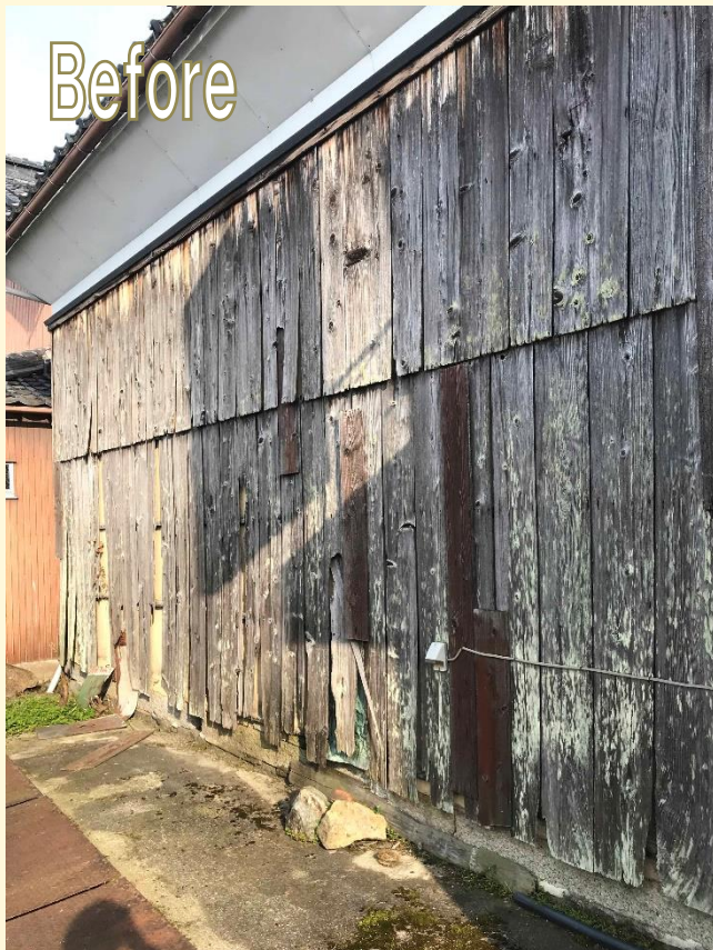
劣化箇所が複数見受けられます。
