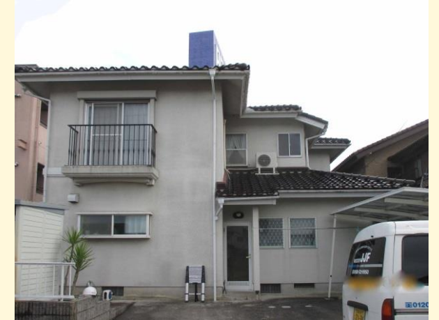
外壁の色が劣化して汚れているのが気になっていました。
