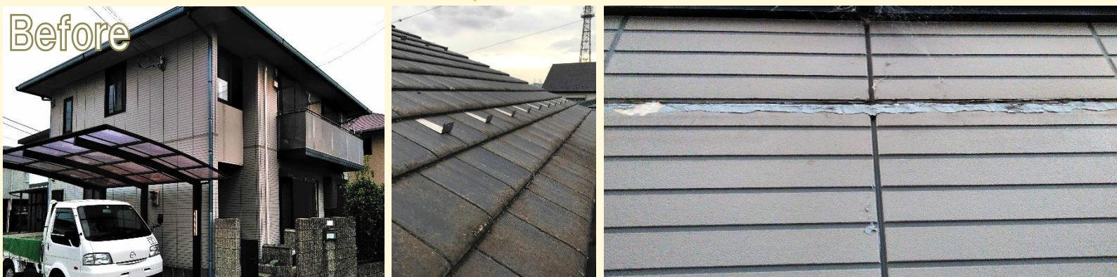
所々に劣化が見受けられます。
