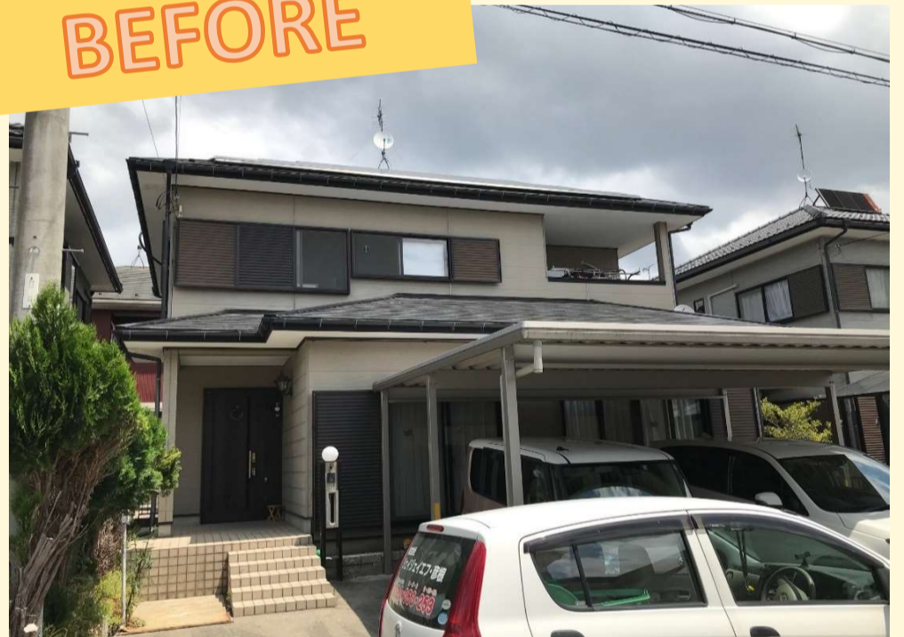
経年劣化が進んでいました
