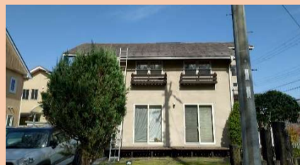
屋根の塗膜劣化と、天災による被害がありました。
