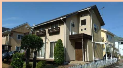
外壁の塗膜劣化と汚れが目立つようになっていました。
