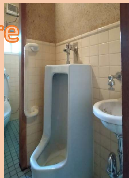
あまり使わなくなった小便器がありました。
